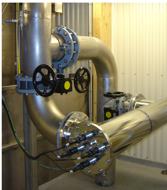
Interiörbild från nybyggt vattenverk.
