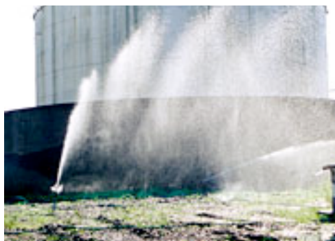
Sanering av oljeförorenat område genom biologisk rening. Biologisk slurry tillsätts genom duschning av överyta eller direkt till grundvattnet.
